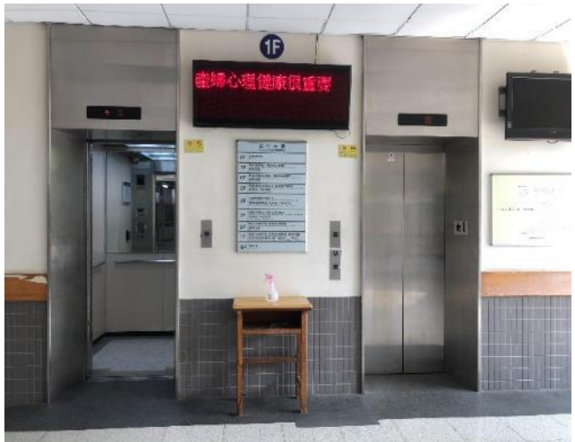
工程大樓-無障礙電梯
