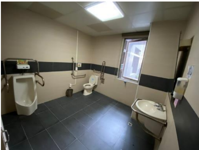
工程大樓-無障礙廁所
